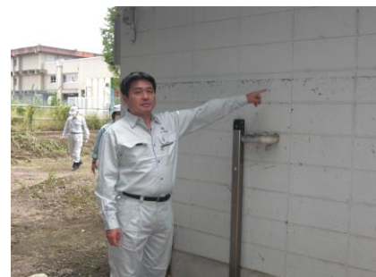
羽川西小の被害状況を調査
